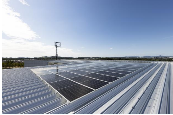
<太陽光パネル>
