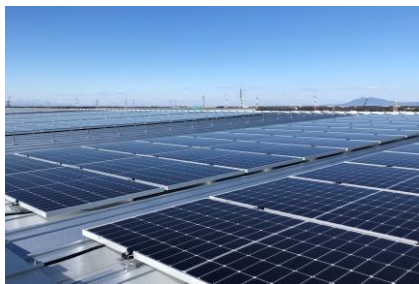
太陽光パネル (屋上)
